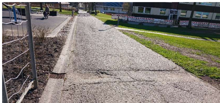
Belægning på stien er slidt – måske pga. vandstrømme? Ønskes nyt asfaltlag.
